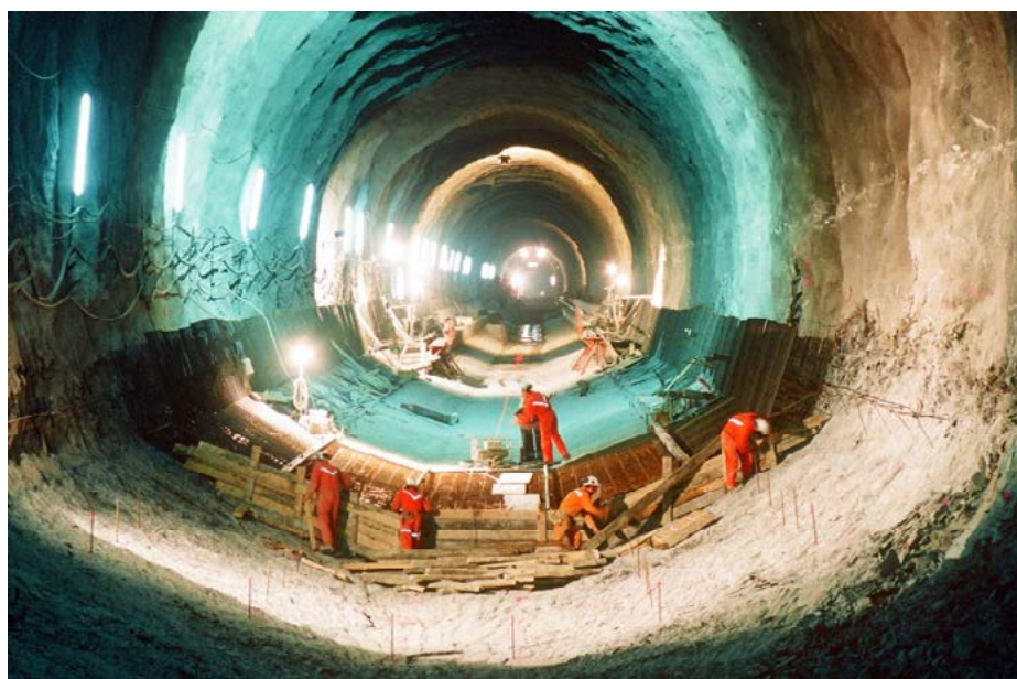
Figure 2.11 – Tunnel profond instrumenté pour le suivi de la construction et à long terme (crédit photographique EGIS).
