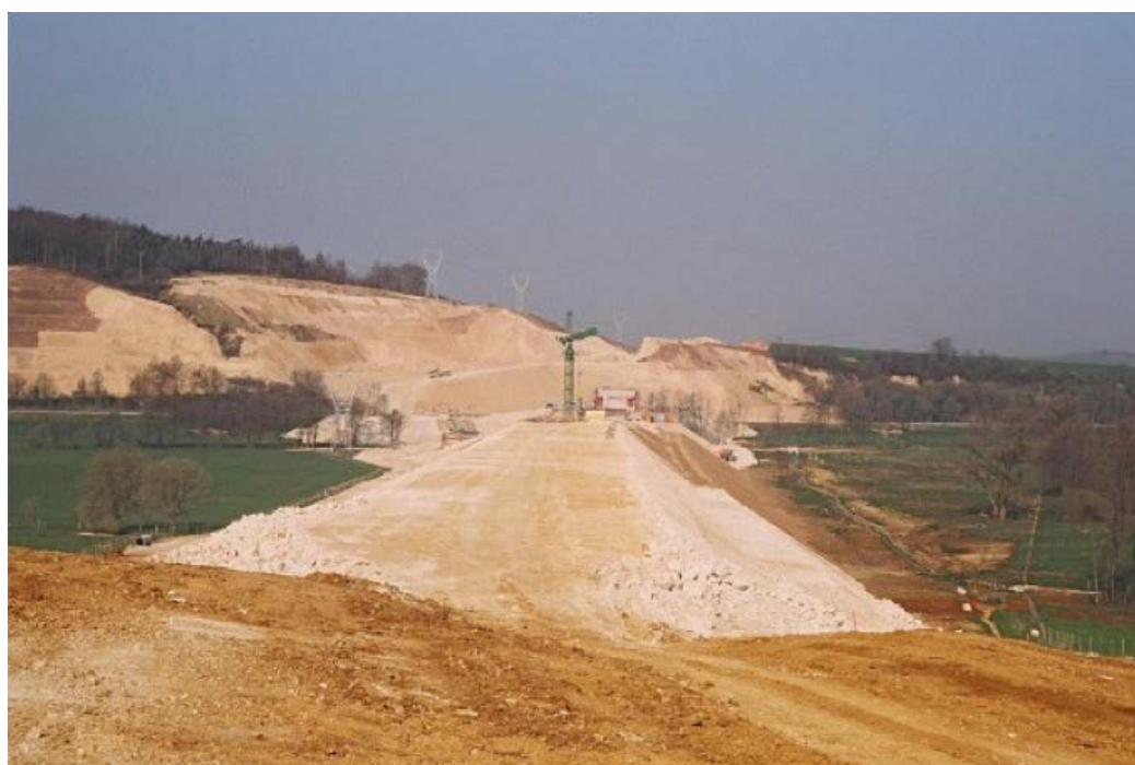
Figure 2.2 - Remblai sur sol compressible – Instrumentation pour suivi de la consolidation et du fluage (crédit photographique : EGIS).
