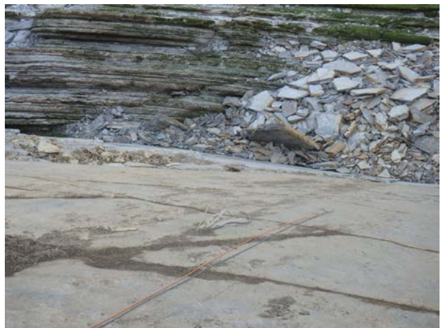
Inclinomètre horizontal après la rupture d'une dalle superficielle (épaisseur <1,0 m)
