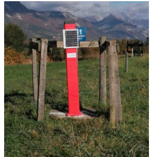
Photo d'un piézomètre équipé d'un IoT
