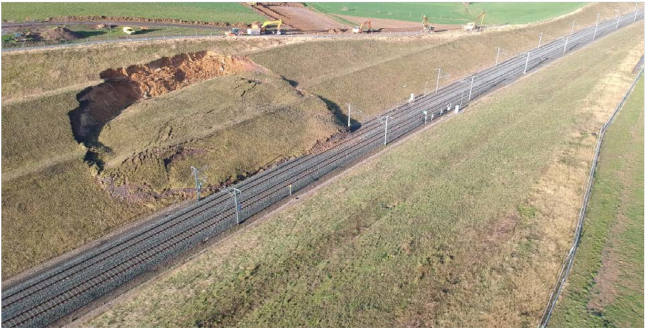
Glissement du talus de déblai côté voie 2 ayant entraîné le déraillement du TGV
