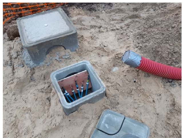
Connectique des CPI avec sa protection
