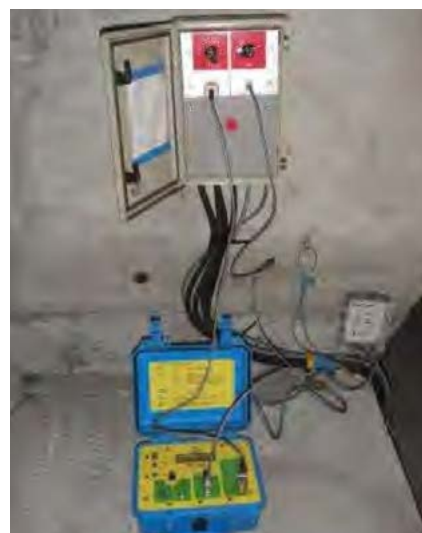
Mesures des cellules de pression Totale
