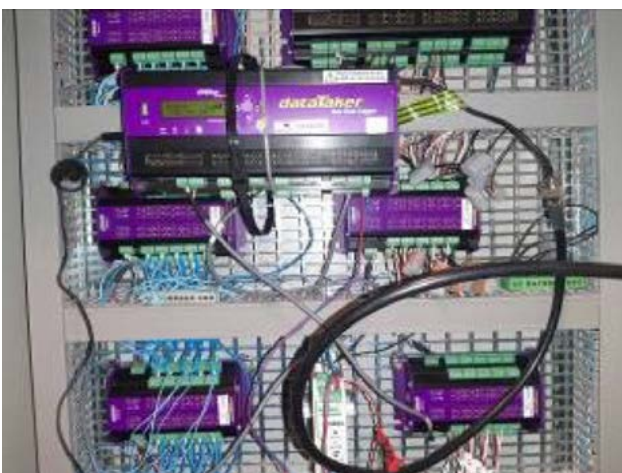
Centrale d'acquisition et multiplexeurs associés
