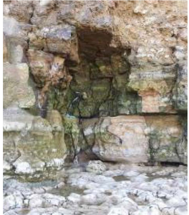
Erosion en pied de falaise : bloc de protection manquant
