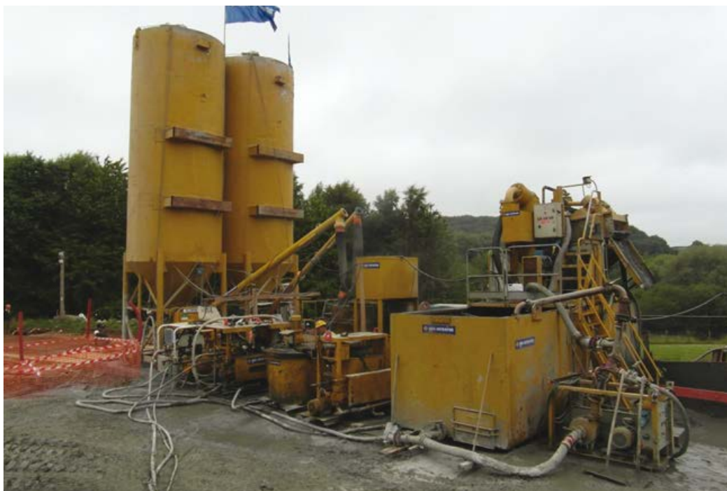
Photo 7.11 : centrale de fabrication de coulis (© Sefi Intrafor)
