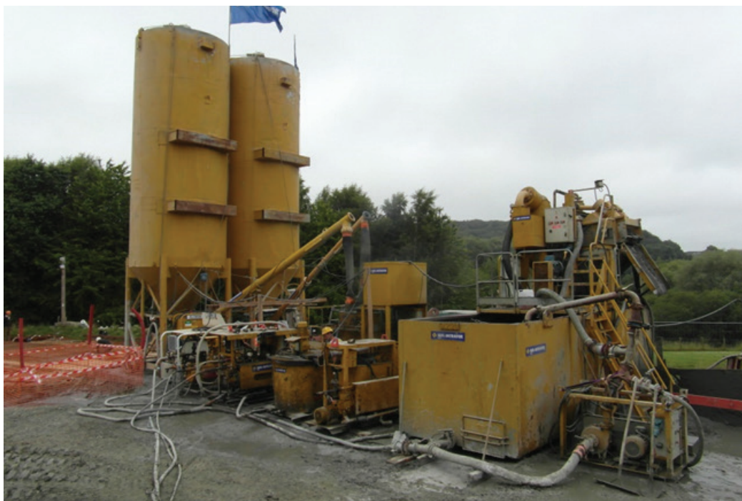
Photo 7.11 : centrale de fabrication de coulis (© Sefi Intrafor)
