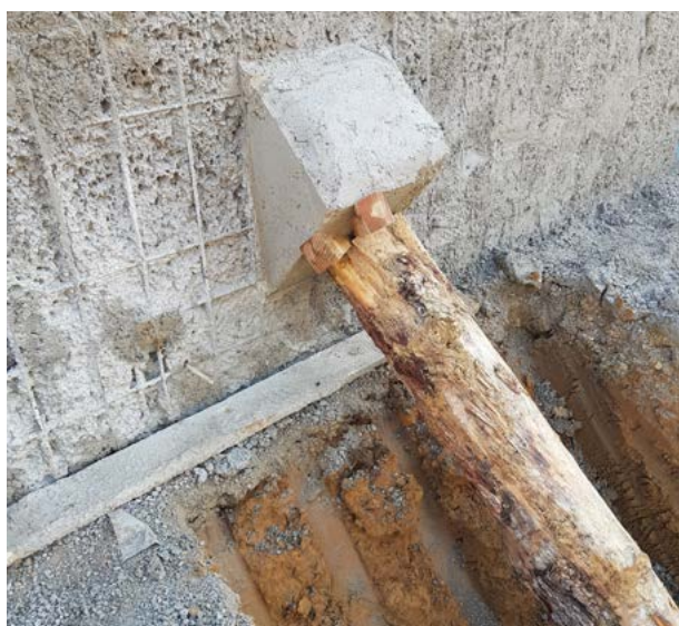
Figure 4-5 : Bouton serré par des coins au niveau du corbeau
