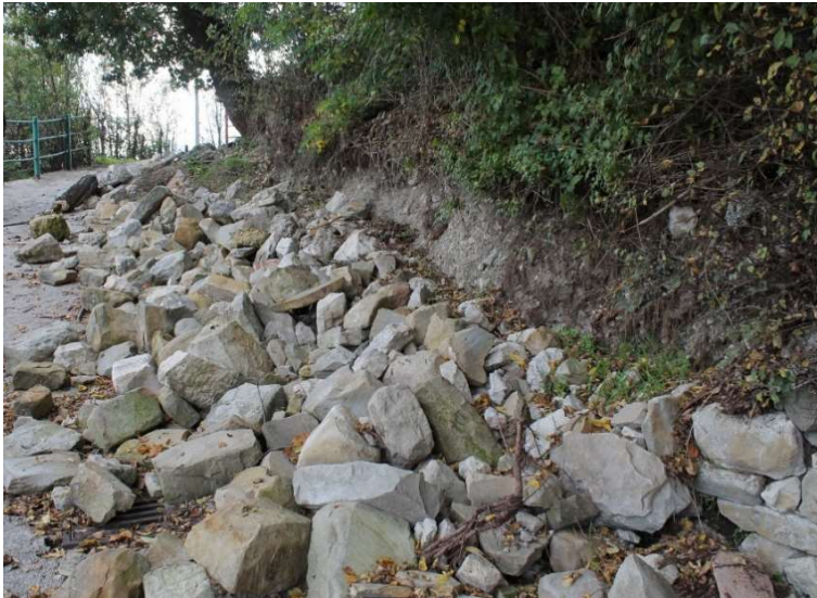
Rupture d'un petit mur en pierres sèches
