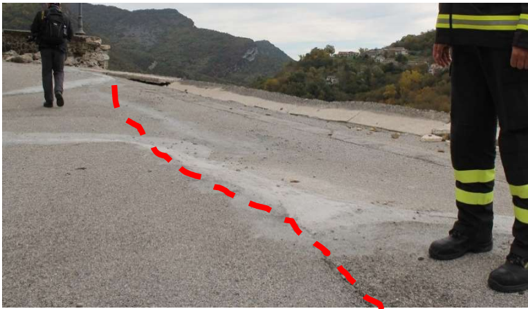
fracture de la chaussée soutenue avec rejet vertical
