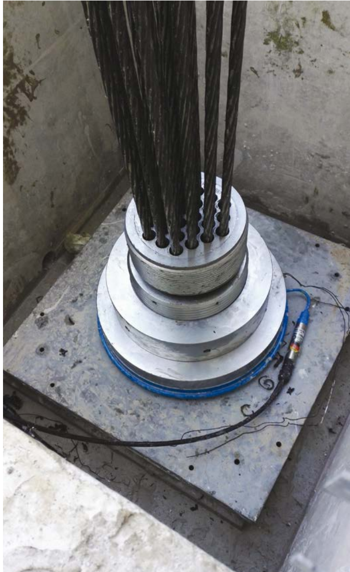
Photo 8.9 : Tête d'ancrage Freyssinet réglable avec cellule de charge démontable (© Alexis Piron-EDF)
