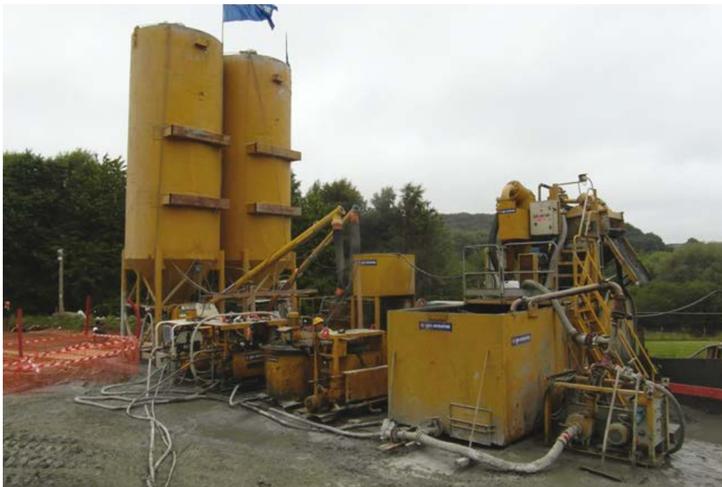
Photo 7.11 : centrale de fabrication de coulis (© Sefi Intrafor)
