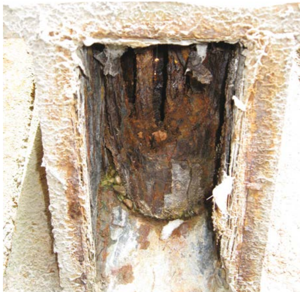
Photo 6.1 : illustration de l'effet d'un défaut de protection au niveau d'une tête d'ancrage (©SMG)
