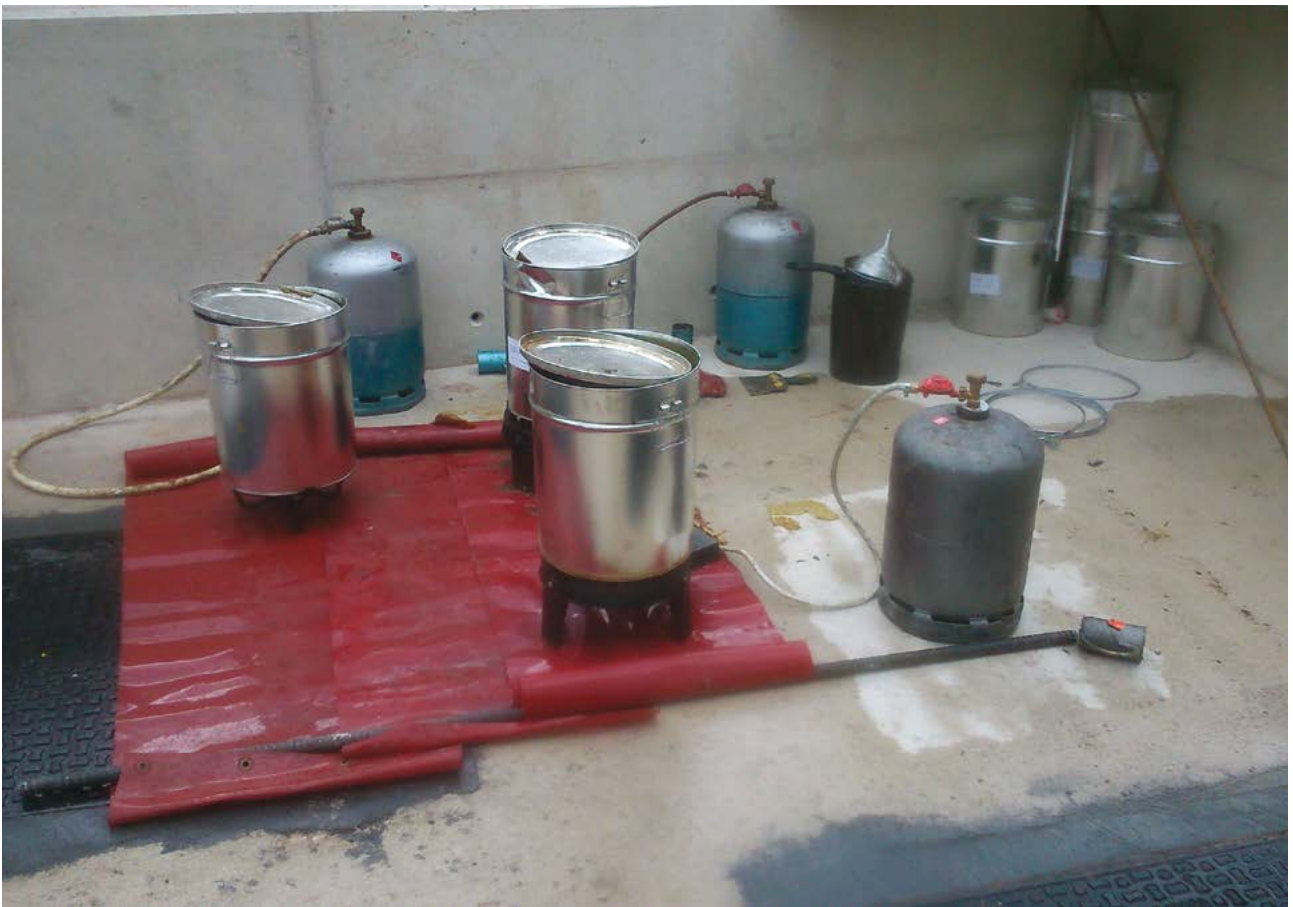
Photo 6.7 : Préparation de cire pétrolière (produit anticorrosion) (© Alexis Piron-EDF)
