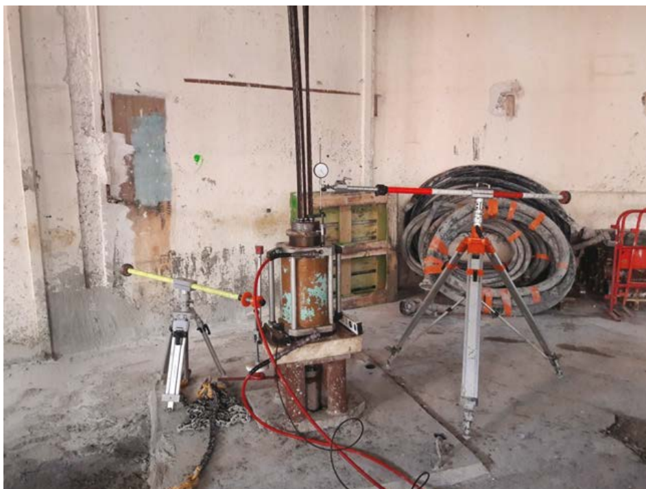
Photo I.5 : Dispositif de mesure des déplacements (© Spie Fondations)
