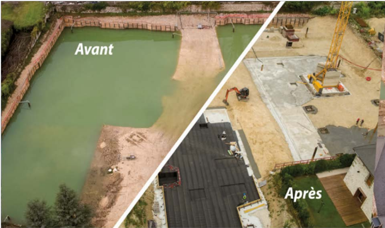
Sur ce site l'absence d'étude préalable et d'anticipation sur le dossier Loi sur l'Eau (LEMA) a conduit à un arrêt de 6 mois.
