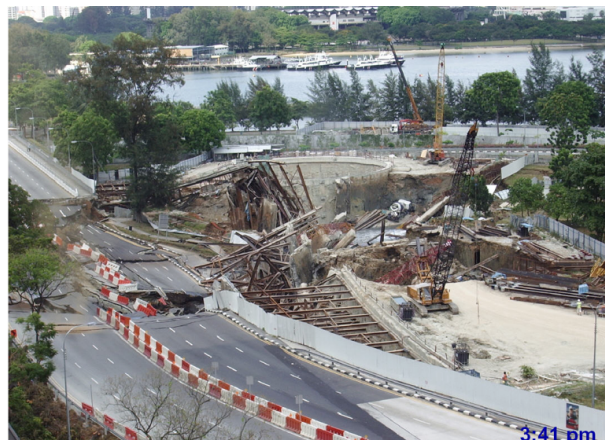
Figure 44 - Nicoll Highway : vue générale du sinistre (ISSMGE).
