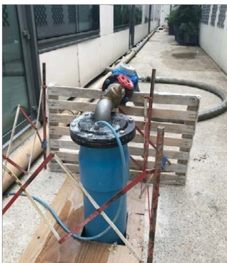
Photographie 27. Tête de puits de rabattement en configuration opérationnelle
