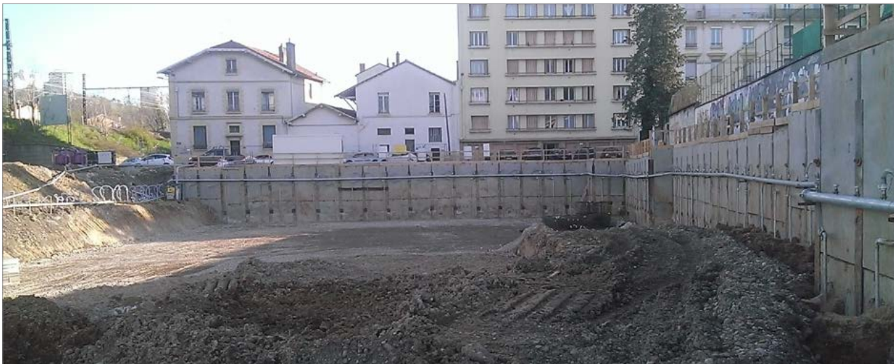
Photographie 33. Points filtrantes sur un rang pour un chantier de rabattement / A. Parrot
