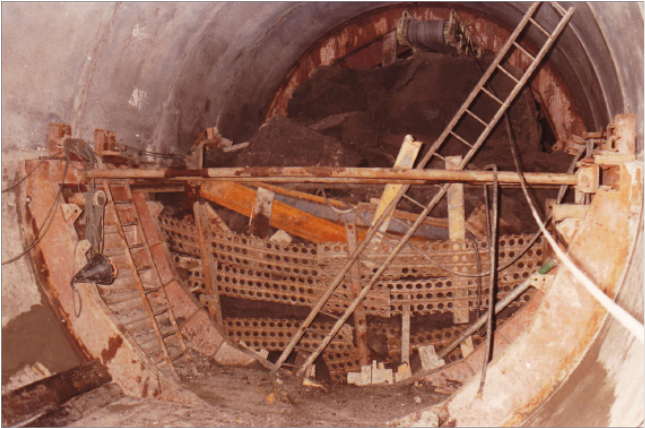
Photographie 15. Soulèvement en galerie creusée dans l'Argile du Gault, dû à la sous-pression de la nappe de l'Albien / EDF
