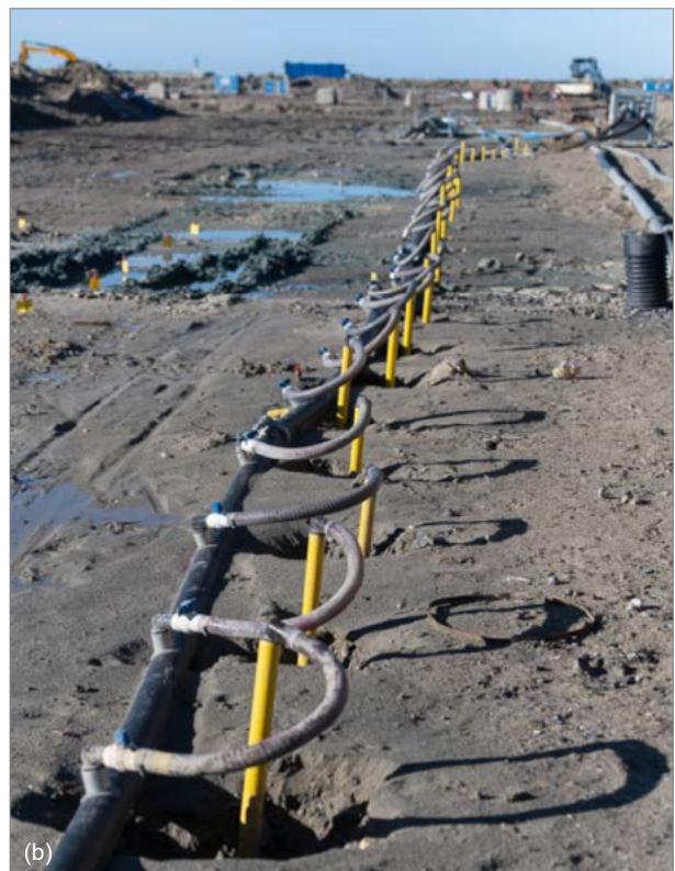
Photographie 30. Installation de pointes filtrantes pour un chantier de paroi moulée / Cédric Helsly
