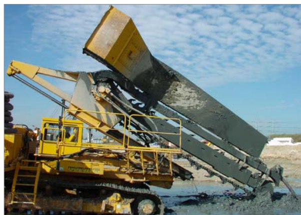
Photographie 34. Trancheuse permettant de creuser sur plusieurs mètres, et de poser le drain et le gravier à l'avancement / E. Garroustet
