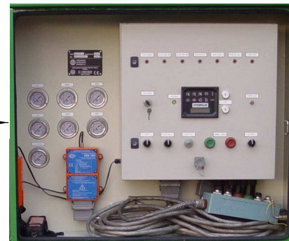
Panneaux de contrôle des centrales hydrauliques
