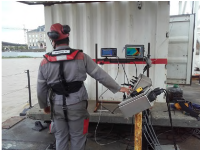
Poste de pilotage du ponton de pose
