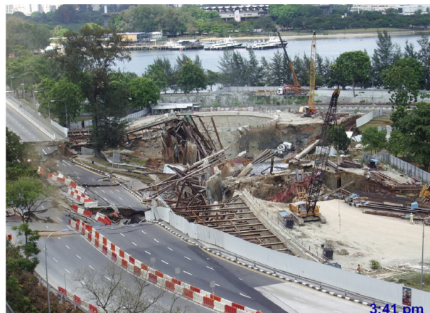
Figure 44 - Nicoll Highway : vue générale du sinistre (ISSMGE).
