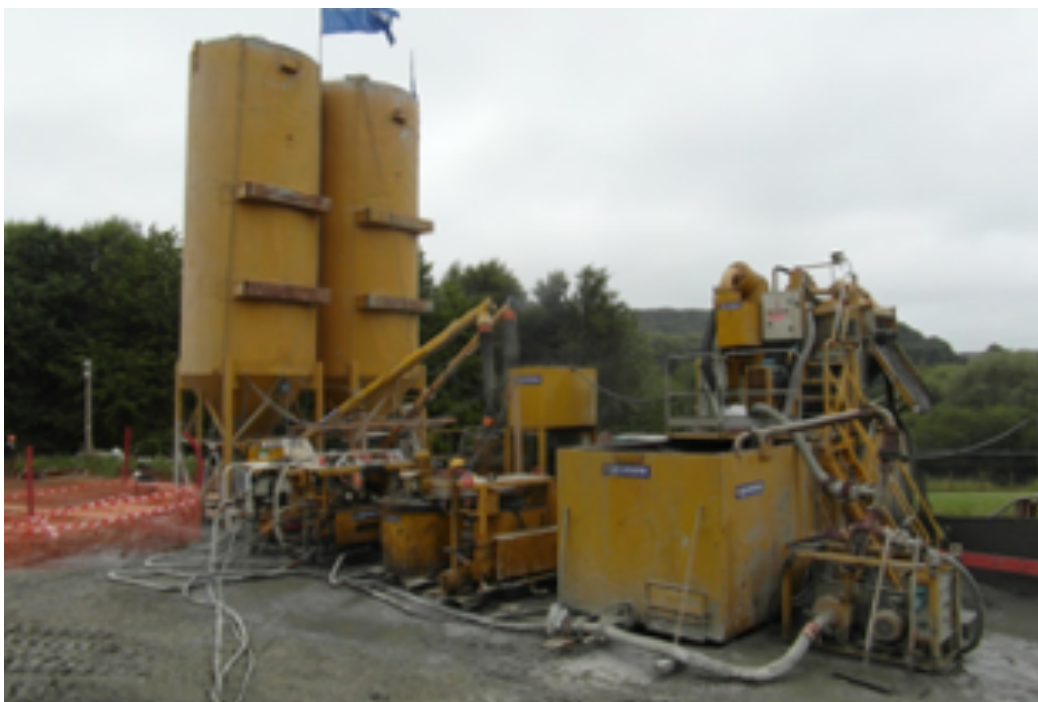
Photo 7.11 : centrale de fabrication de coulis (© Sefi Intrafor)
