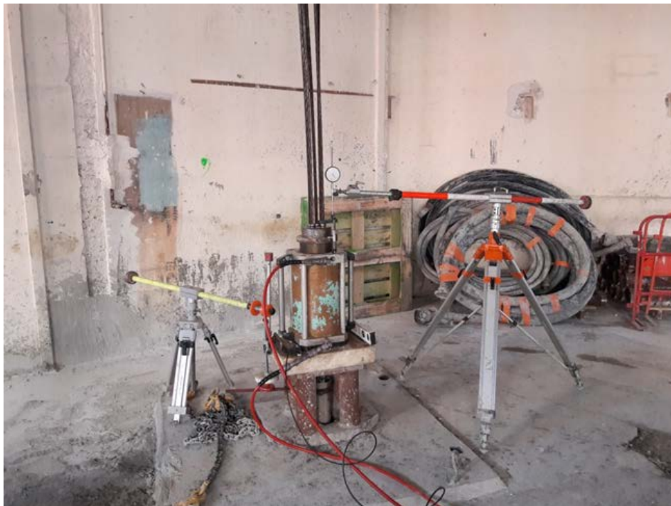
Photo I.5 : Dispositif de mesure des déplacements (© Spie Fondations)
