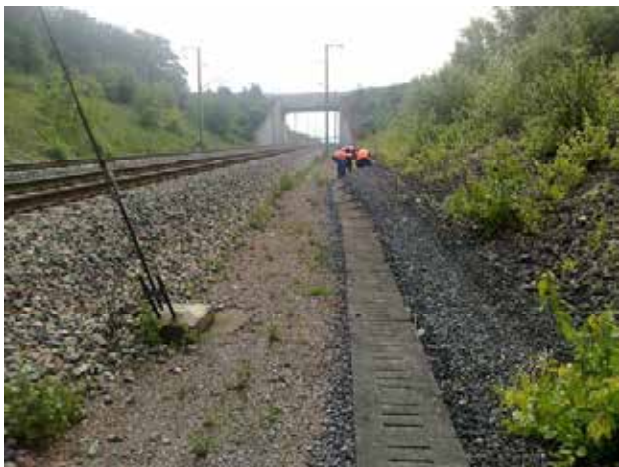
Photo 2: Exemple d'incident peu grave sur la LGV Est Européenne – glissement d'un talus de déblai avec soulèvement de la piste et du fossé
