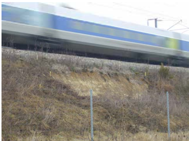
Photo 4 : Glissement de bord de remblai sur la LGV Est Européenne
