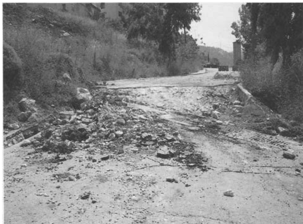
Figure 3. Route Faouar Antélias-Raboueh coupée par le glissement.
